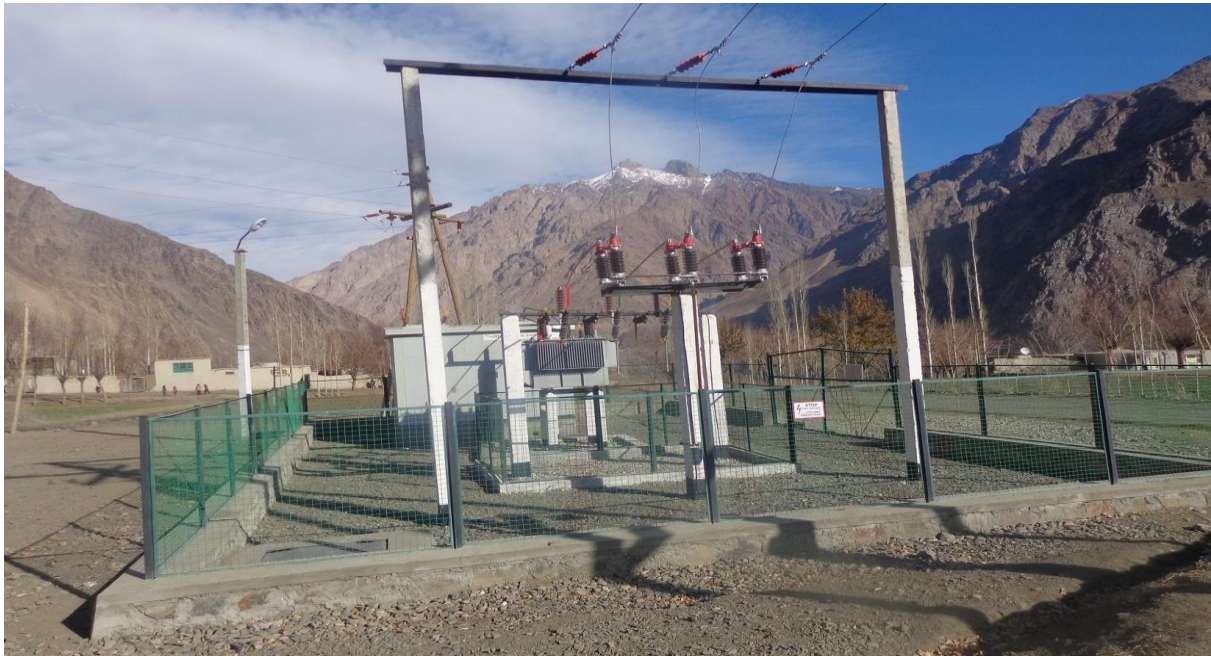
ترانسفارمر برق قریه شدوج- شغنان
